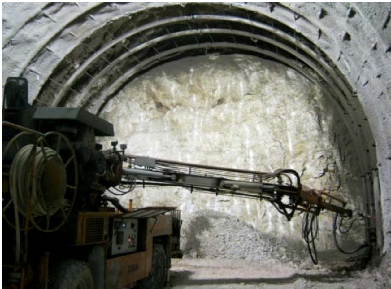
Figura 8: Marcos tubulares instalados para la experimentación de campo en el túnel Varano
