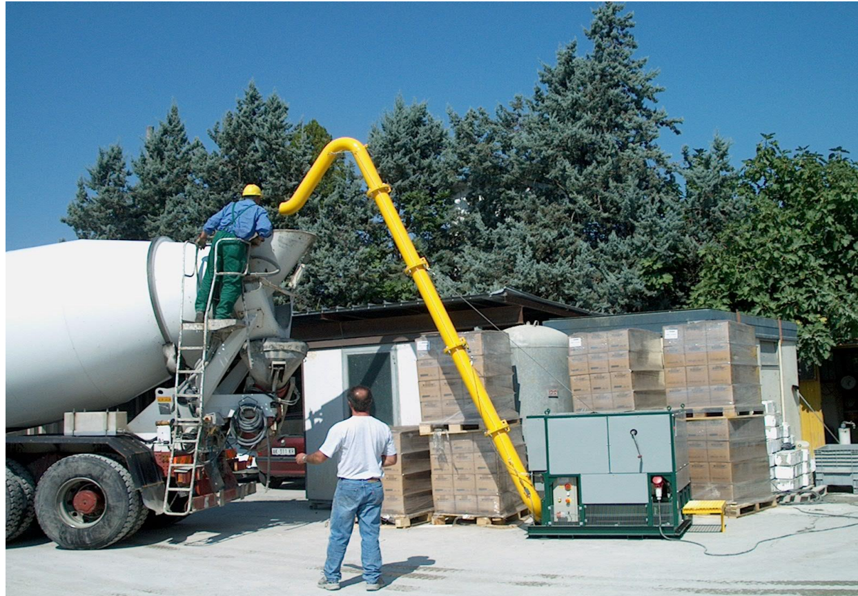
Inserción de fibras en camión mezclador a través de la planta procesadora de cajas
